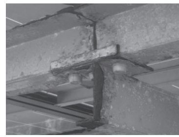
(a) 塩害による腐食
